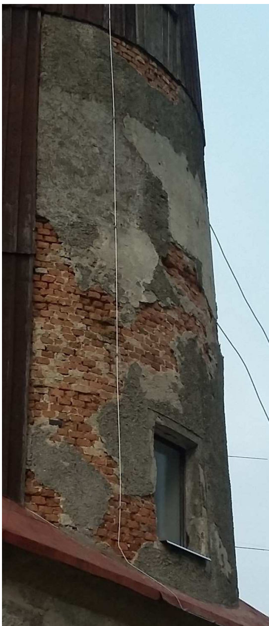
Poničená a zvětralá omítka
