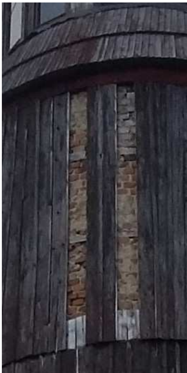
Poničený a chybějící dřevěný obklad
